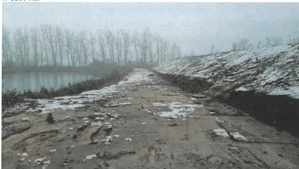
Zdjęcia nr 17 - 19. Zdjęcia przedstawiają efekty wykonania kolejnego etapu rekultywacji składowiska odpadów w Ostrowie.
